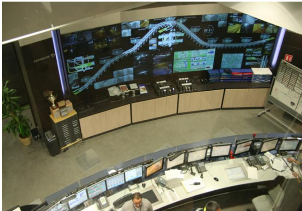
Figure 9 – vue du poste central de contrôle du Duplex A86
