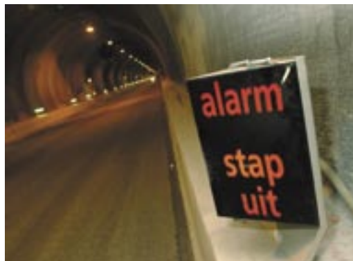
Figure 39 : message d'alarme spécifique pré-enregistré utilisé dans le tunnel de Westerschelde (les mots néerlandais "stap uit" signifient "sortez de votre véhicule")
